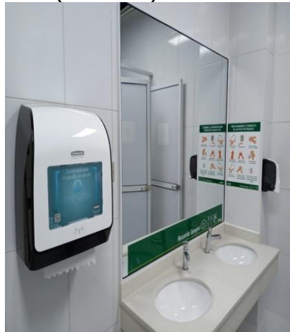
(Foto N° 2) Baños
